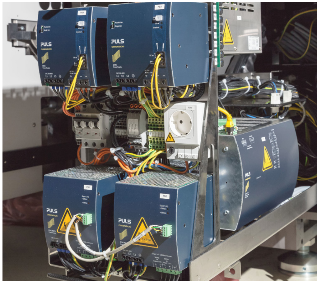
Für ASM hat PULS mehrere Standard-Netzgeräte, zwei modifizierte Stromversorgungen und eine rein kundenspezifische Baugruppe zu einem höchst effizienten Komplettsystem vereint.
